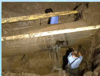
抢修人员清理管道爆裂部位
